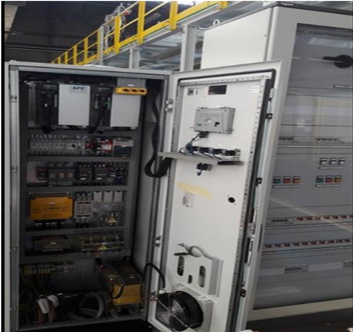
Fig.32 quadro convertitore e quadro pompe
