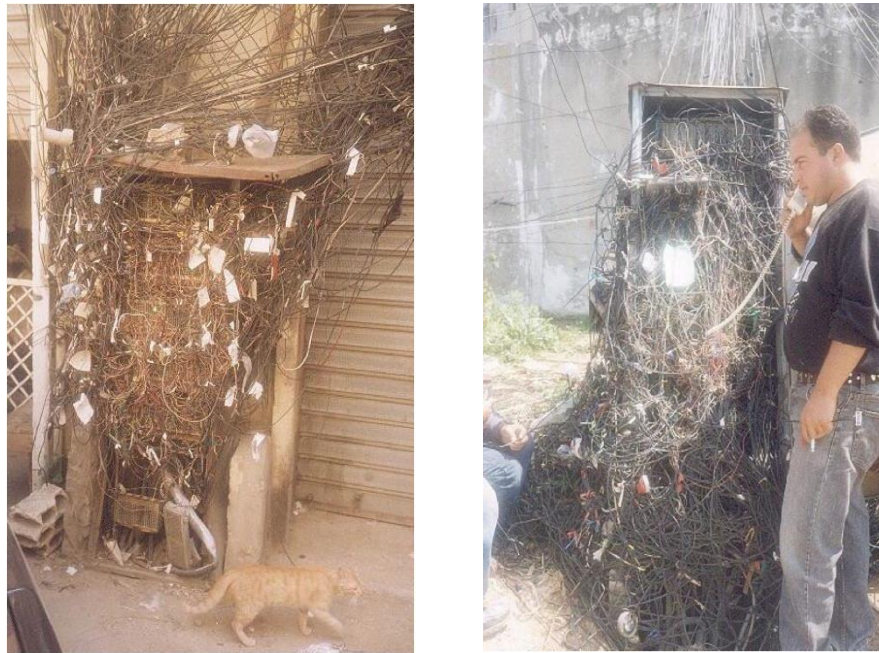
Figura 1.1 Situazioni in cui i cavi risultano gravemente non sicuri e difficilmente ordinabili
