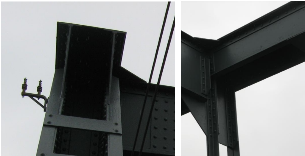
Figura 2.4 – Corrente superiore a cassone con piattabande, due anime e angolari di collegamento.
