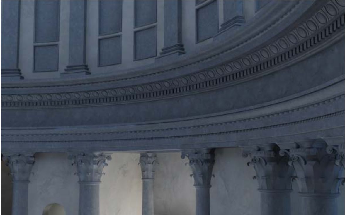
Figura 39: Vista della trabeazione interna del primo ordine con applicazione dei materiali (vedi capitolo 5.2)
