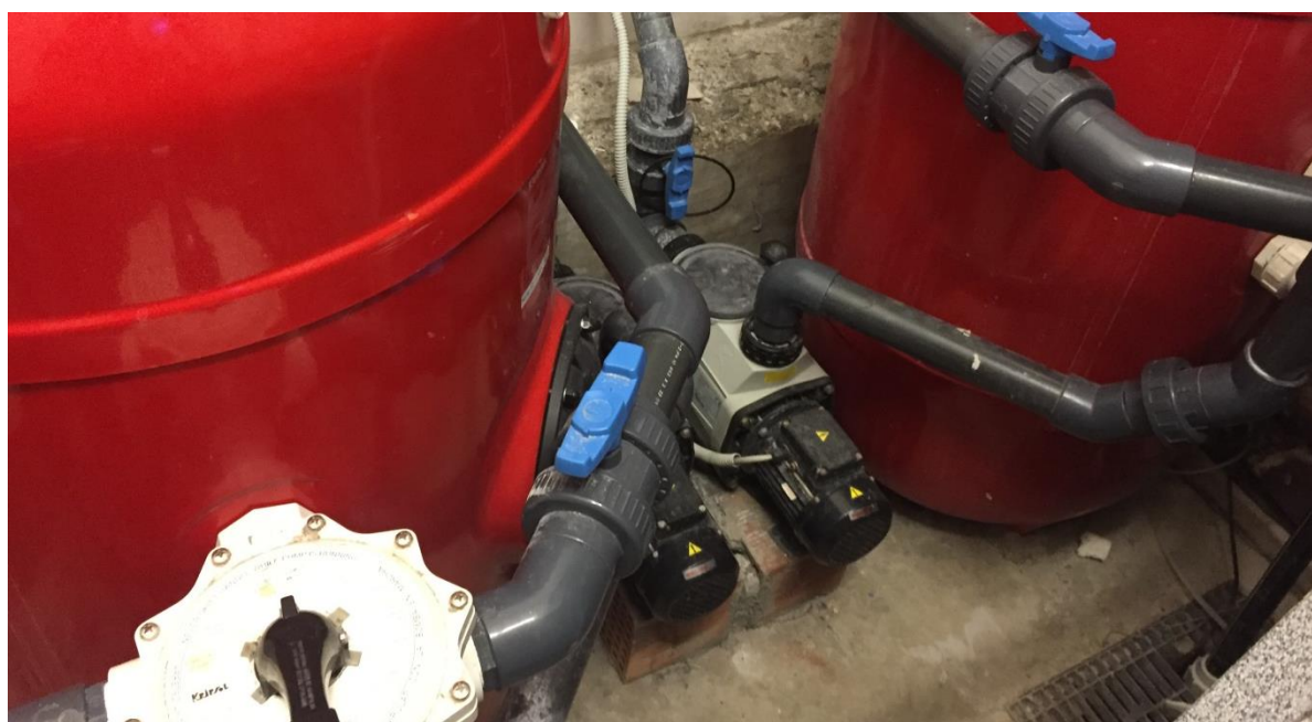
Fig. 3.16 - Particolare dei filtri per il ricircolo dell'acqua della vasca
