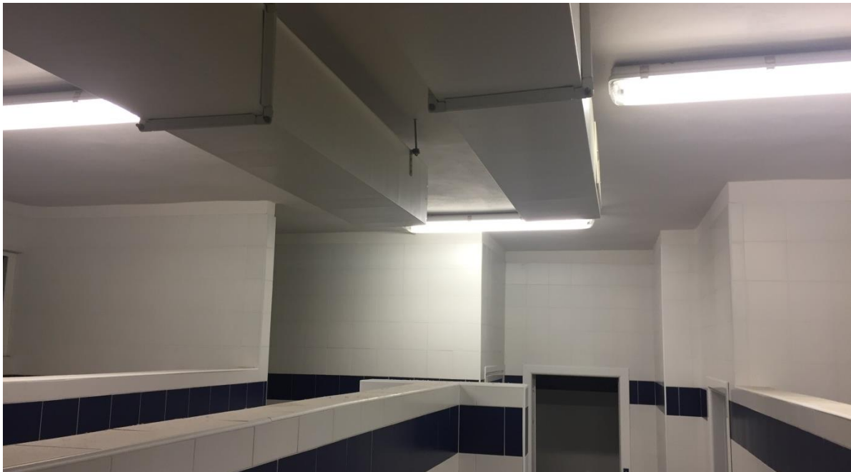
Fig. 3.13 - Particolare unità trattamento Aria UTA
