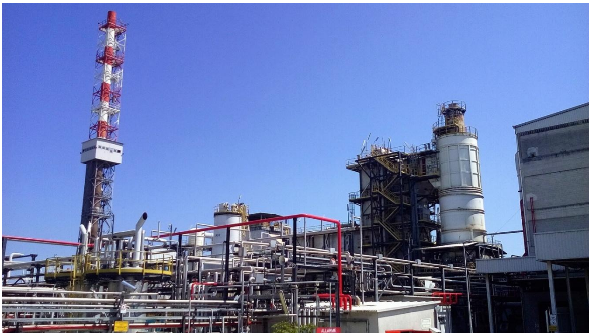
Figura 51: Visione della parte posteriore dell'impianto di termodistruzione F3; (Catterin 2016).
