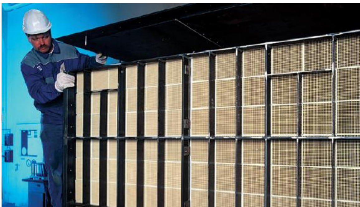
Figura 62. Operatore che svolge funzioni di controllo ad un catalizzatore a nido d'ape; (www.jmsec.com).
