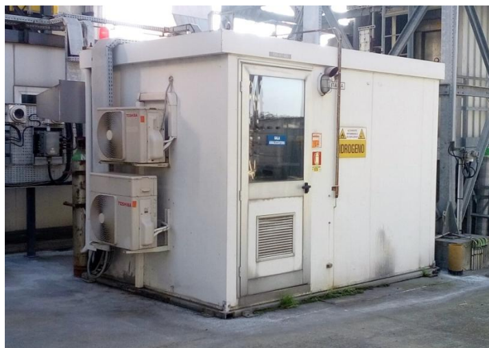
Figura 55: Cabina analisi impianto F3; (Catterin 2016).
