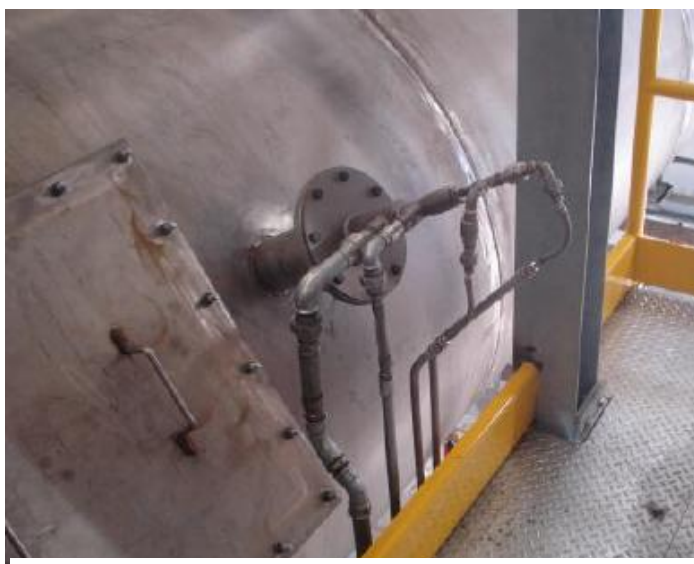
Figura 65. Particolare della lancia per il dosaggio dell'ammoniaca, dotata di camicia esterna per il raffreddamento forzato. Sulla sinistra è visibile il portello di ispezione della zona di miscelazione; ( www.deparia.com ).
