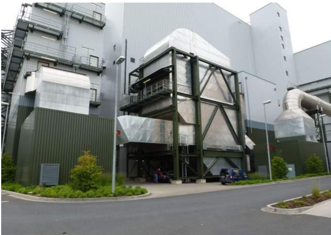
Figura 68. Sistema SCR installato dalla Johnson Matthey nell'impianto di termovalorizzazione di rifiuti urbani nella città di Hameln (D); ( www.jmsec.com ).
