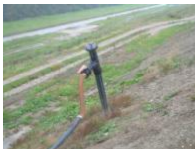
Figura 8.20. Testa di pozzo
