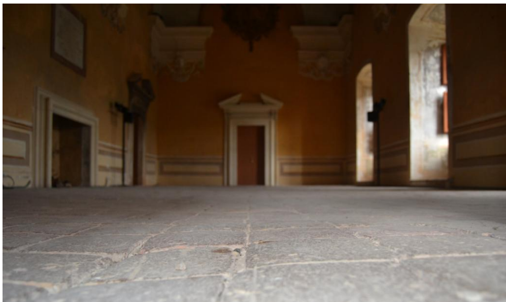
Deformazione del pavimento del salone d'onore
