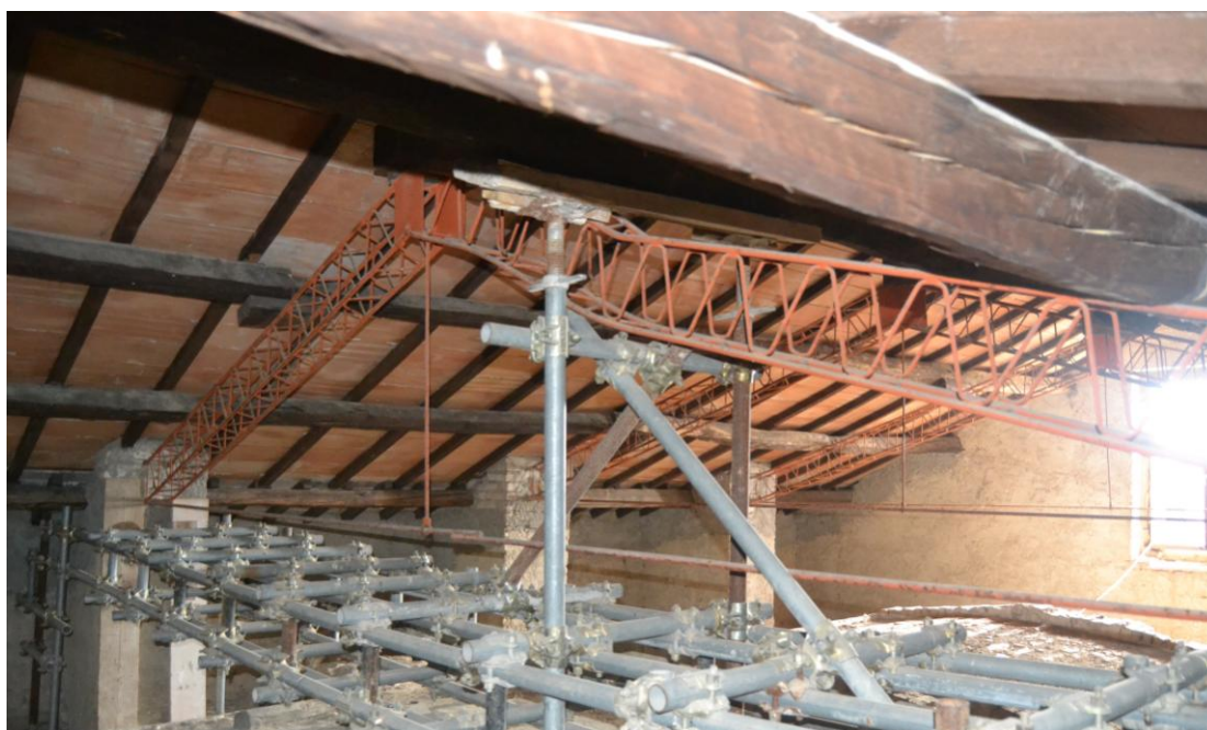
Cedimento del puntone (traliccio) della capriata metallica
