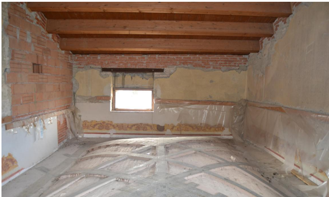
Estradosso volta della sala del Pergolato, intervento di consolidamento tramite fibra di carbonio (dicembre 2005)
