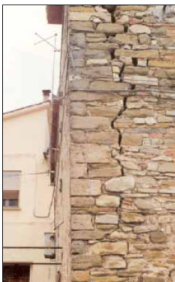
Figura 1.9 Esempio di danno causato da carenza di ammassamento tra le pareti
