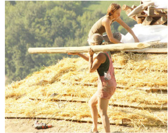
Fig. 5.1. Esempio di cantiere con misure di sicurezza insufficienti
