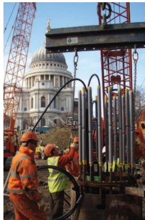
Figura 9. Un particolare di un palo equipaggiato con tubi scambiatori dell' "One New Change".
