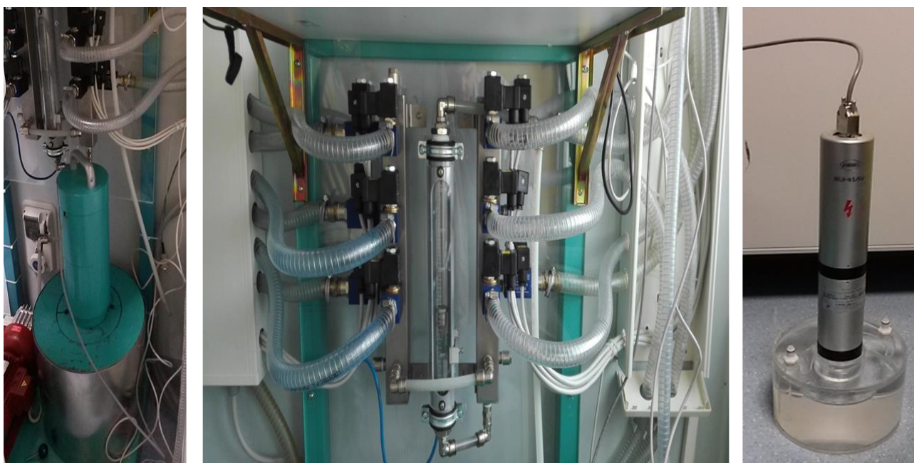
Figura 17 - a) Pozzetto schermato in piombo. b) Sistema delle elettrovalvole; c) Rivelatore NDI in geometria Marinelli.
