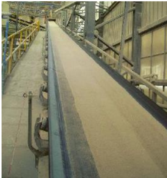
Fig2.2 – Esempio di nastro trasportatore installato in un'industria ceramica (Fonte: C.Saccani, A. Bianchini, M.Pellegrini - Environmental impact reduction in the ceramics industry: conveying parameters control for atomized slip pneumatic transport)
