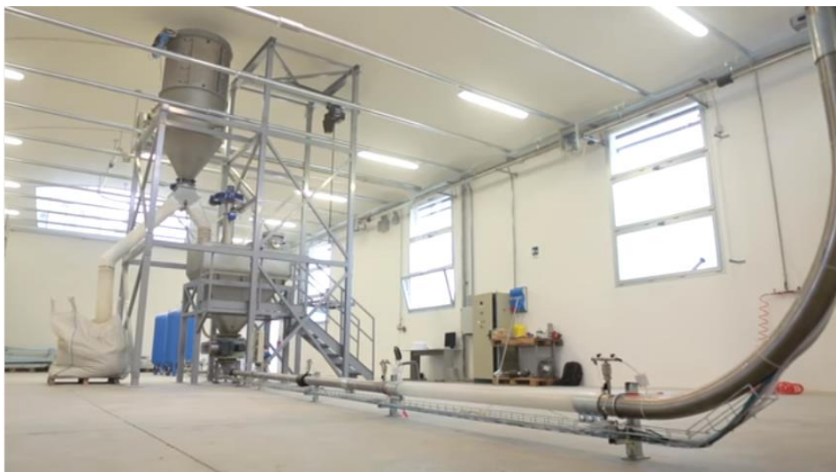
Fig1.4 – Impianto di trasporto pneumatico sperimentale sito in Technosilos
