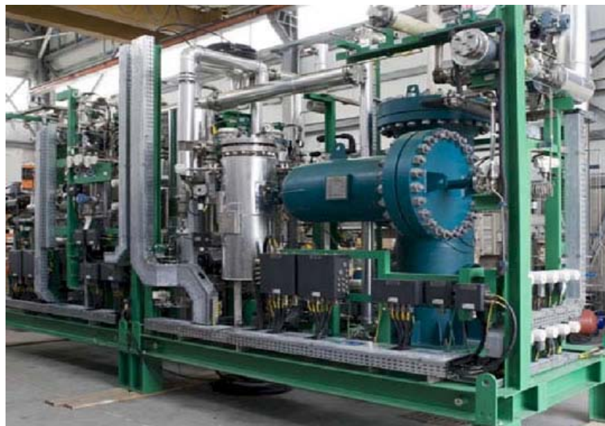
Figura 6: L'impianto SCT-CPO di Mantova
