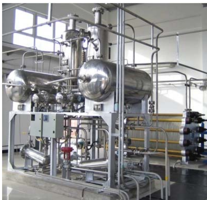
Figura 10: Elettrolizzatore - Fonte: MVS Engineering
