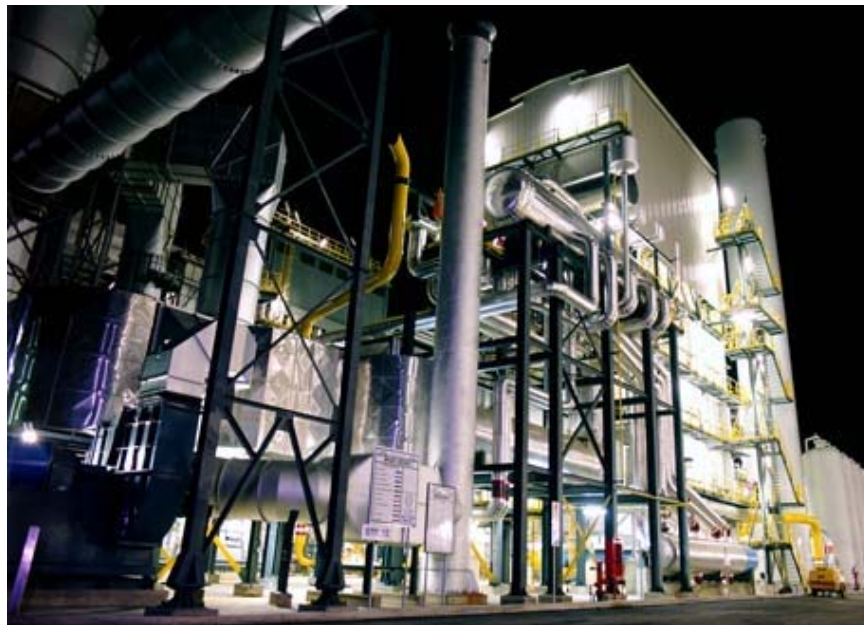
Figura 3: Steam Reformer - Fonte: Linde
