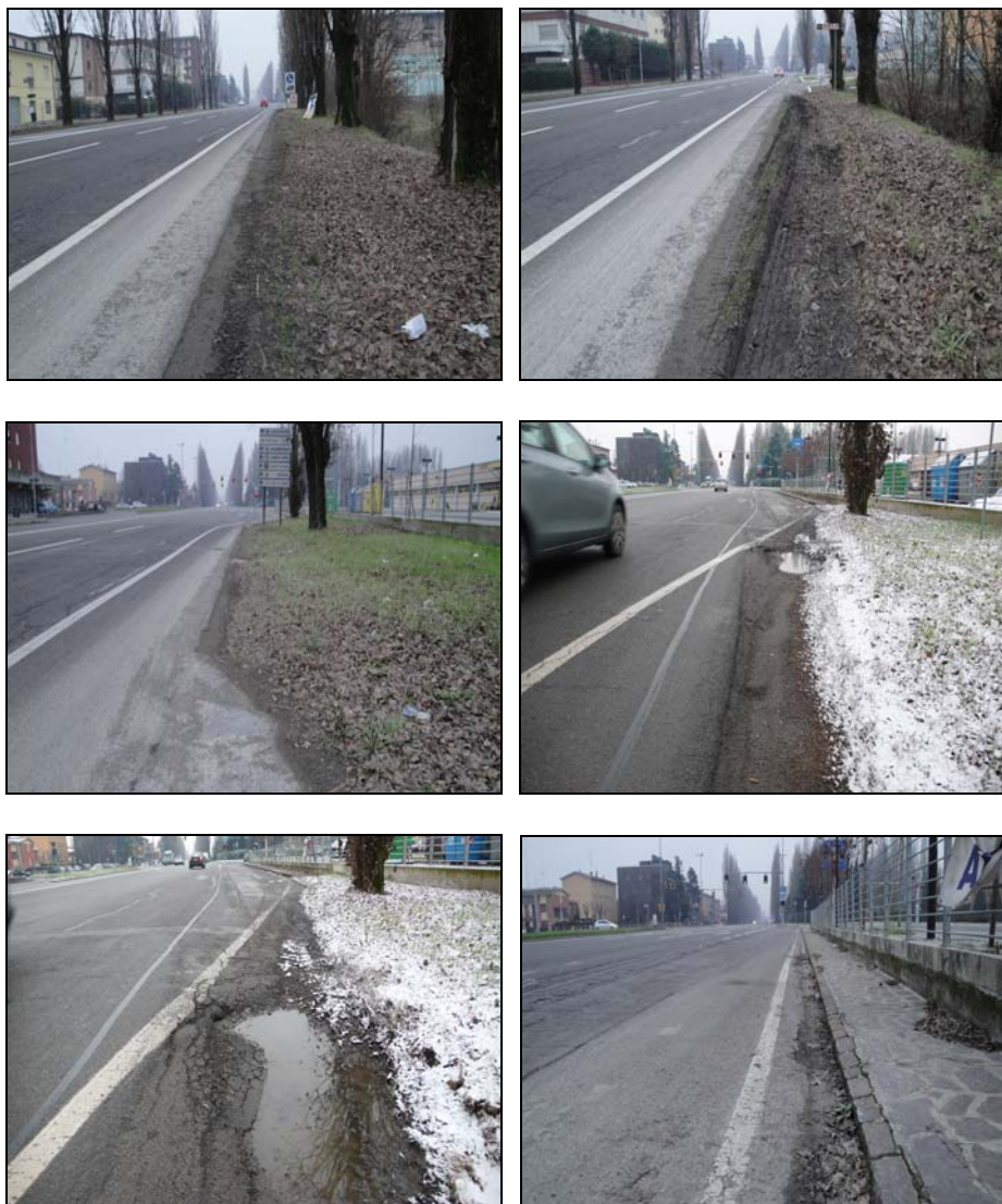
Foto 65: immagini sulle condizioni della banchina e cunetta
