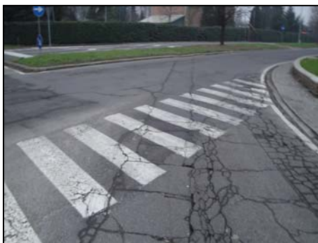
Foto 86: foto di attraversamento pedonale degradato e poco visibile
