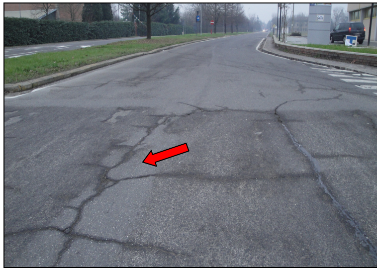
Foto 42: foto di pavimentazione degradata
