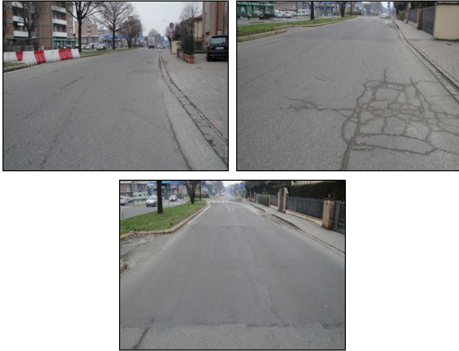
Foto 160: esempio di segnaletica orizzontale assente o poco visibile
