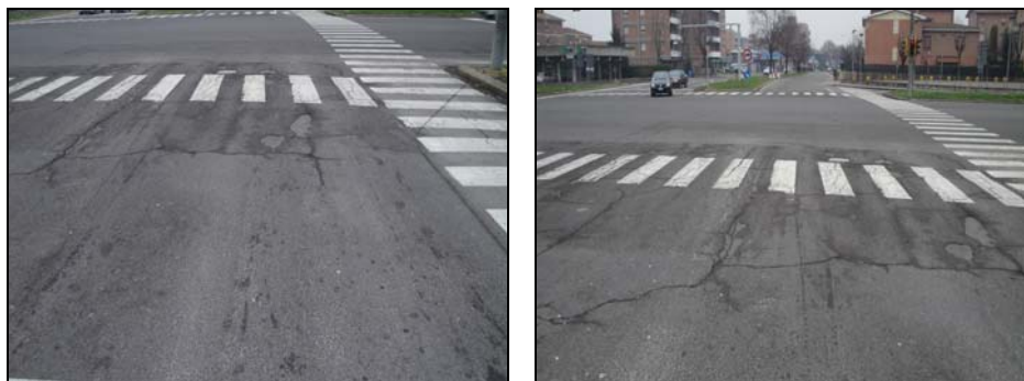
Foto 112: immagini sullo stato degli attraversamenti pedonali
