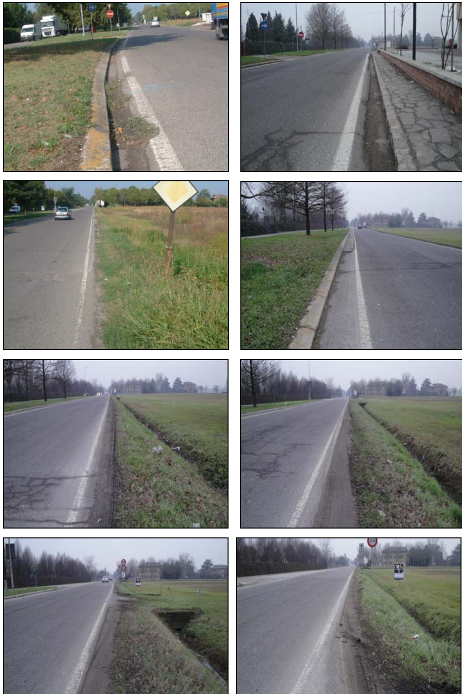
Foto 96: immagini riguardanti le condizioni della banchina e cunetta
