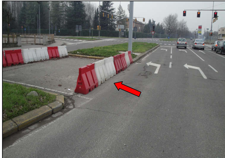
Foto 43: foto di elementi a margine pericolosi
