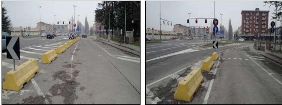
Foto 144: esempio di segnaletica verticale pericolosa
