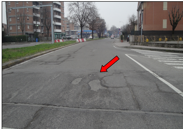
Foto 44: foto di pavimentazione degradata
