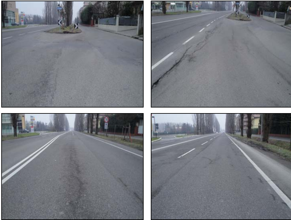
Foto 89: immagini inerenti alle condizioni della pavimentazione
