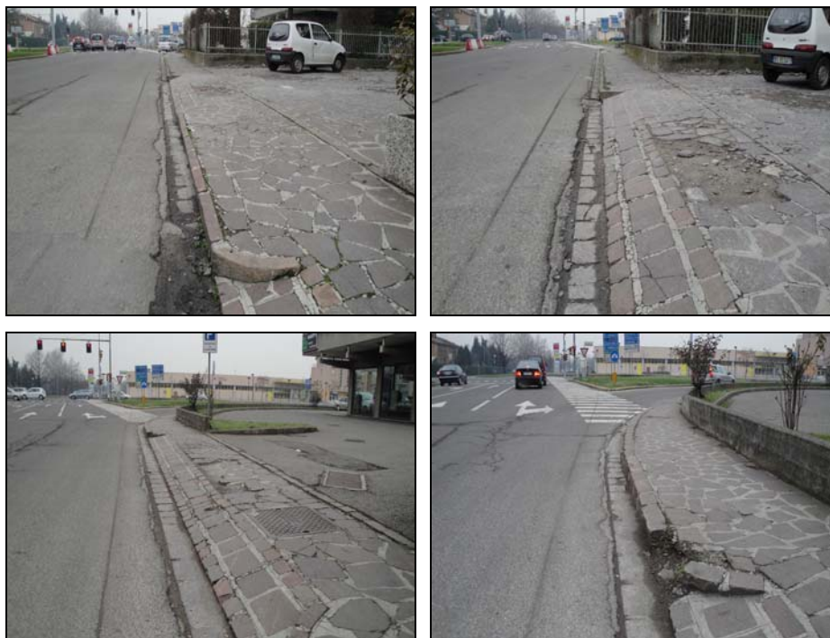
Foto 162: esempio di marciapiede degradato e pericoloso
