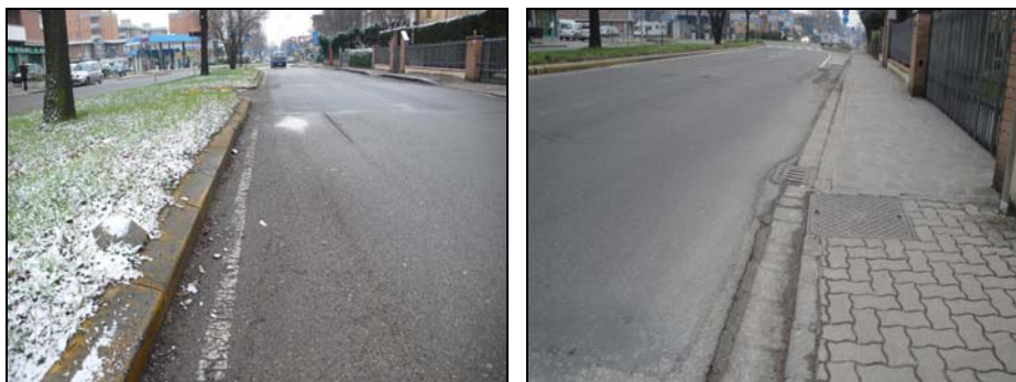
Foto 152: immagini sulle condizioni della banchina
