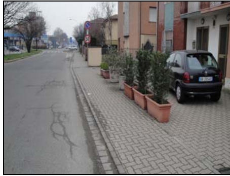
Foto 156: esempio di arredo urbano pericoloso
