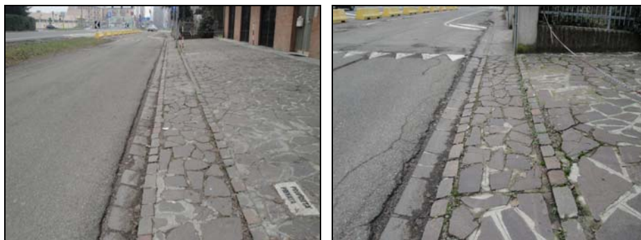
Foto 140: immagini dello stato di degrado del marciapiede
