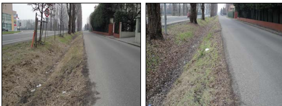
Foto 171: immagini della banchina e della cunetta
