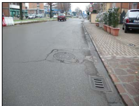
Foto 151: esempio di tombini con raccordo mal eseguito
