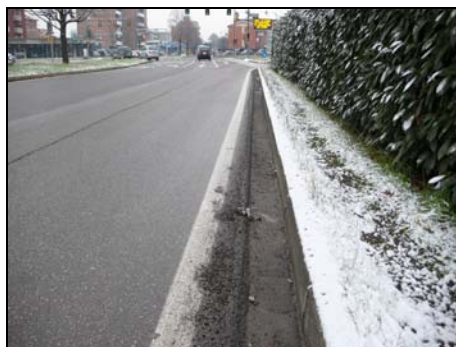
Foto 108: immagini di marciapiedi pericolosi
