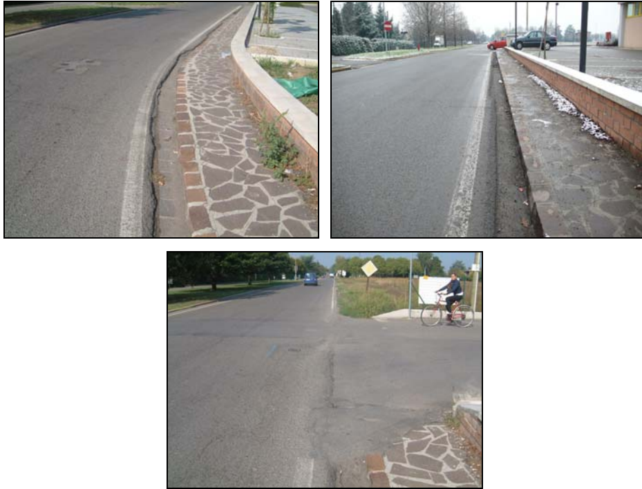
Foto 99: immagini di marciapiedi pericolosi
