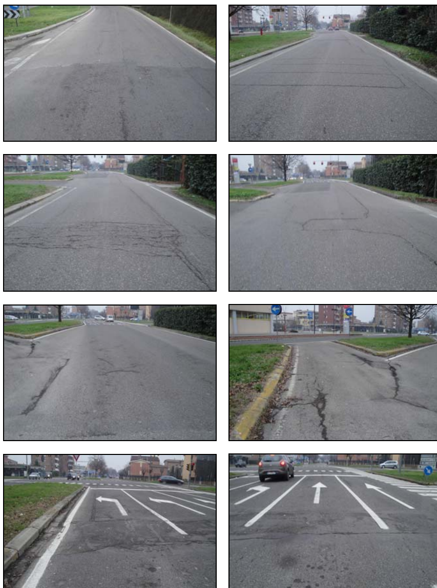
Foto 103: immagini di pavimentazione degradata
