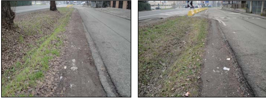
Foto 138: condizioni della banchina e della cunetta
