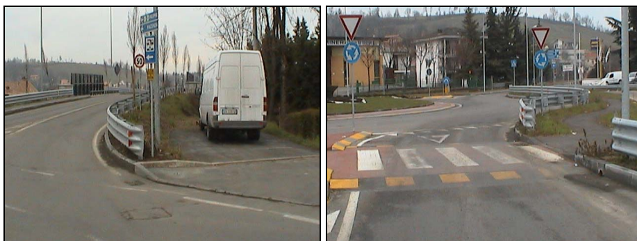
Foto 72: terminali di barriera di sicurezza: installazione da rivedere
