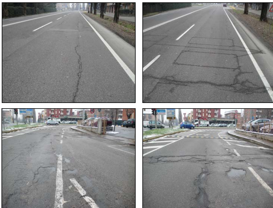
Foto 120: immagini di pavimentazione degradata
