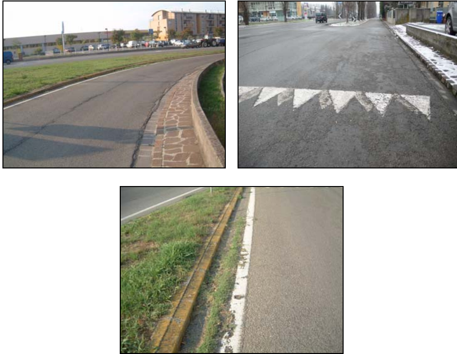
Foto 167: esempio di segnaletica orizzontale degradata e poco visibile
