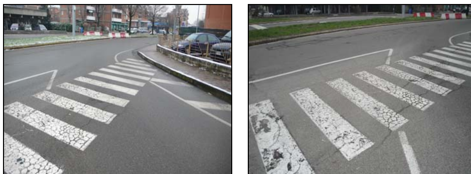
Foto 133: esempio di attraversamento pedonale degradato
