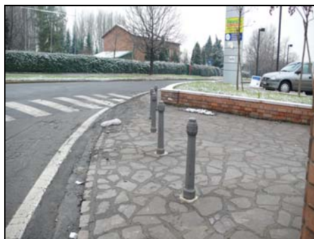
Foto 78: immagine di arredo urbano potenzialmente pericoloso
