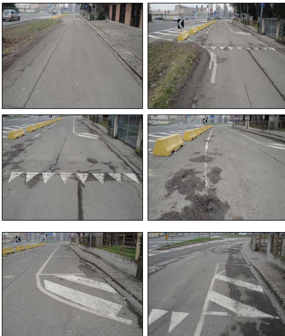
Foto 145: esempio di segnaletica orizzontale poco chiara e degradata
