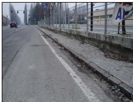
Foto 75: immagini di marciapiede deteriorato
