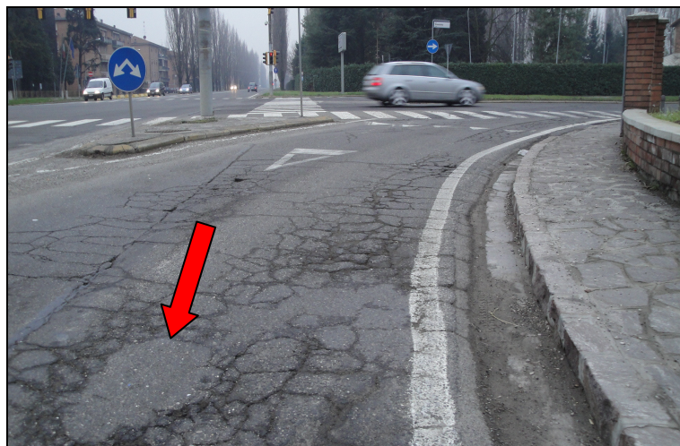
Foto 39: foto di pavimentazione degradata
