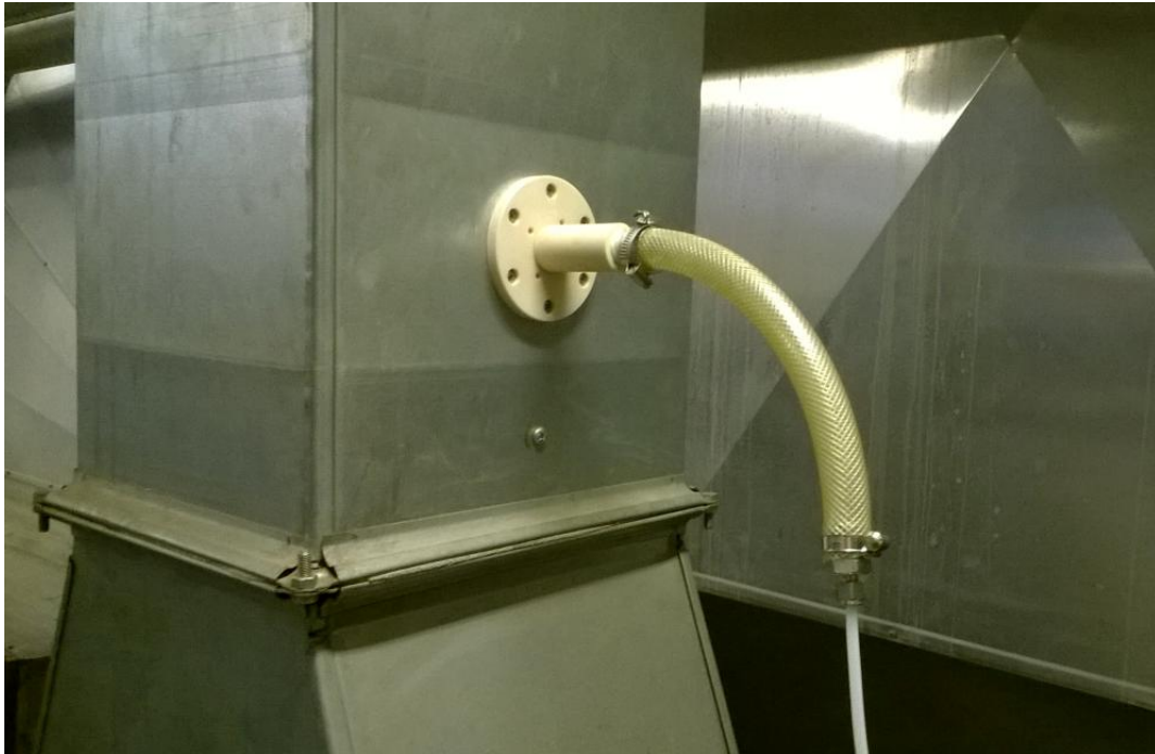
Figura 38: Apparato montato nel condotto di estrazione dell'aria
