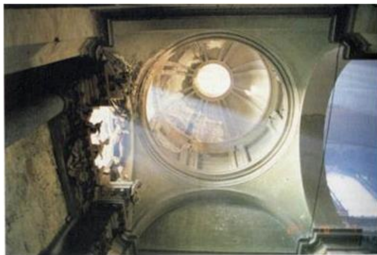
Figura 86: Stati di degrado di un altare e di un cupolino della navata laterale (Archivio storico website).
