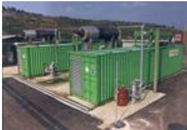
Figura 6.5: Biotunnel presenti nell'impianto di Sant'Agata Bolognese
