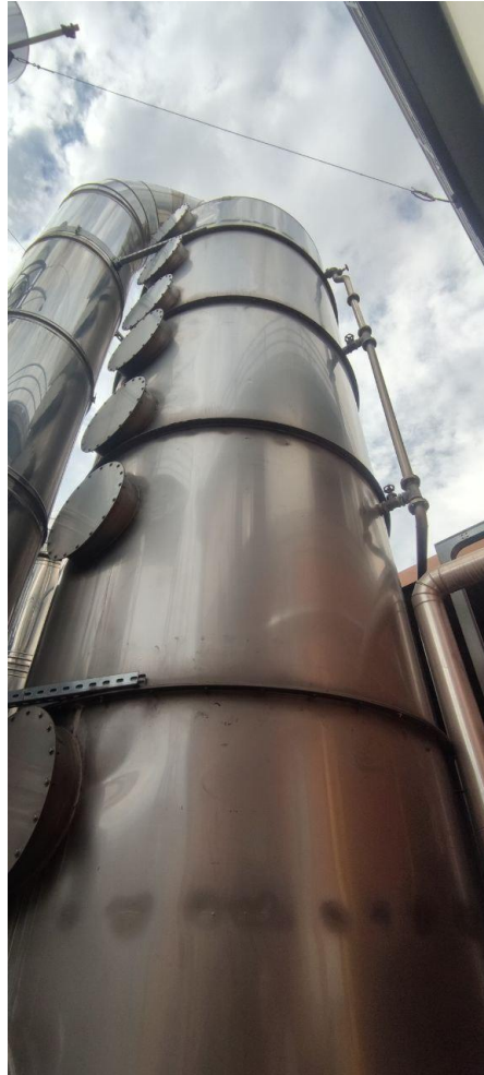
Figura 13b Impianto scrubber dell'azienda Tessiltoschi
