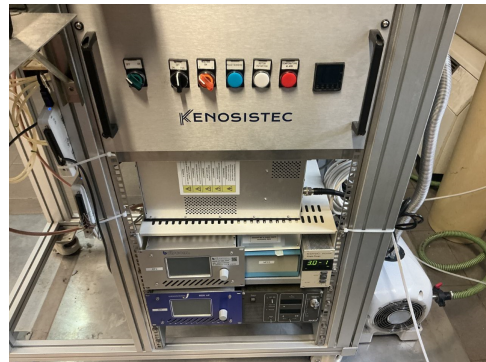
(d) Al centro, pulsanti di controllo. In basso, alimentatori delle torce. In basso a destra, pompa scroll per il vuoto.
