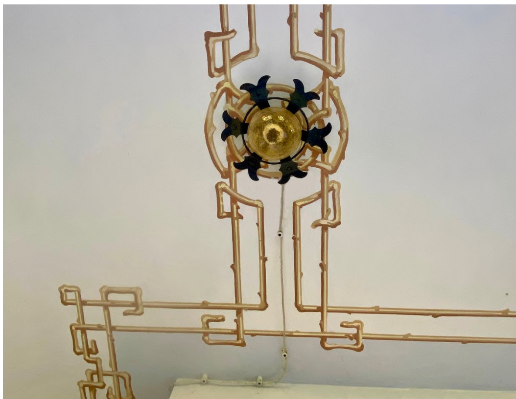
Fig. 29_ Esempio di un punto luce a plafone con collegamento a vista. (Immagine scattata in loco)
