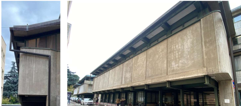
Figura 59 – Foto zona ponte termico
