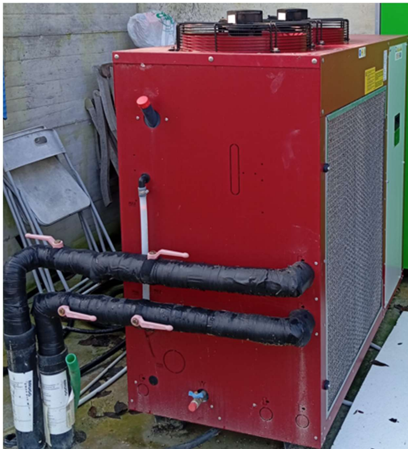
Fig. 9 Impianto di refrigerazione dei mosti
