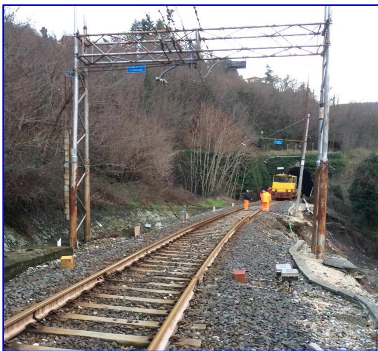
Figura 17: Situazione del binario la mattina del 5 Gennaio.
