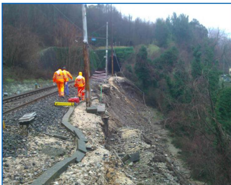
Figura 1: Situazione del rilevato ferroviario la mattina del 5 Gennaio.
