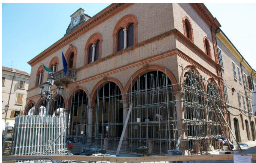
Municipio dopo il sisma con sostegni temporanei al loggiato
