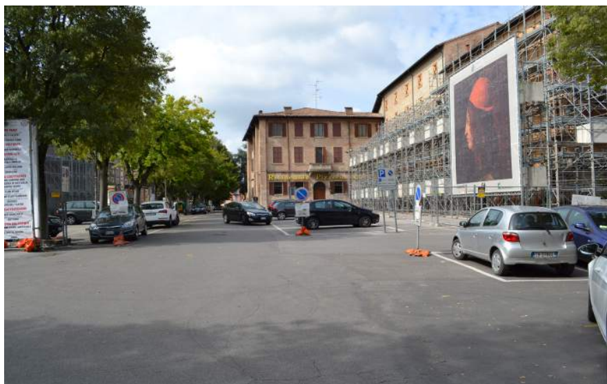
Castello della famiglia Pico dopo il sisma con strutture di consolidamento temporanee
