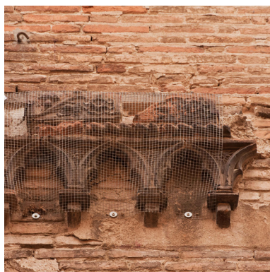
Fig. 3.100 Frammenti di fascia marcapiano su via Comandini. Ora protetti dalla caduta.
