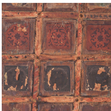
Fig. 38. Soffitto a cassettoni decorato appartenente alla stanza d'angolo al piano terra della casa torre.
