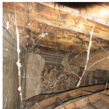
Fig. 3.110 Lo spazio occupato dai tre ambienti voltati era una volta il salone antico affrescato con grottesche.
