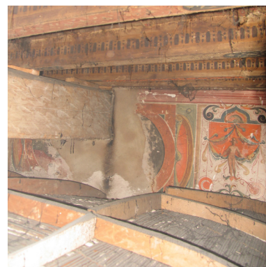
Fig. 3.79 Soffitto S3.1 Estradosso della falsa volta in arelle intonaca. Piano terra del palazzo quattrocentesco.
