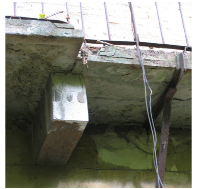
Fig. 47. Mensola parallelepipedica del ballatoio, con scolpite lettere romane.
