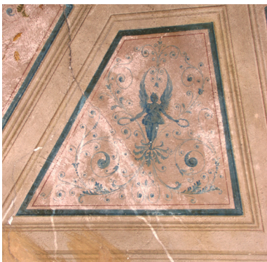
Fig. 3.128 Particolare della volta su cui si è posata una pellicola scura.
