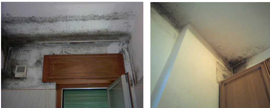
Figura 2-5 – Formazione di muffa in corrispondenza di punti critici della costruzione
