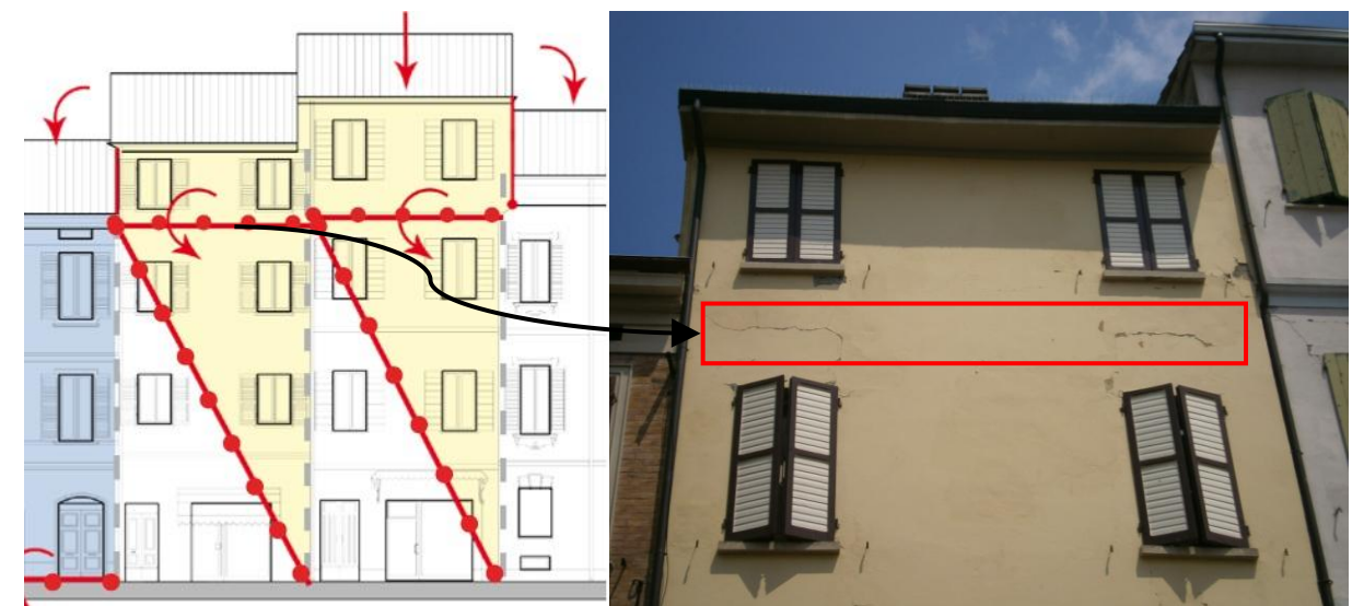
Figura 8-4 Confronto fra meccanismo di ribaltamento della sopraelevazione ipotizzato e rilievo del danno. Il meccanismo si è attivato.
