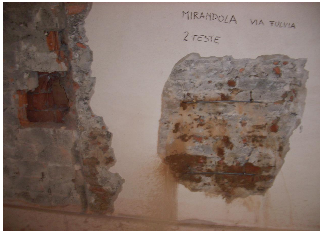
Figura 5-5 Fotografia scattata durante un rilievo in un edificio di tre piani fuori terra. E' evidenziato il numero di teste rinvenuto sotto l'intonaco.
