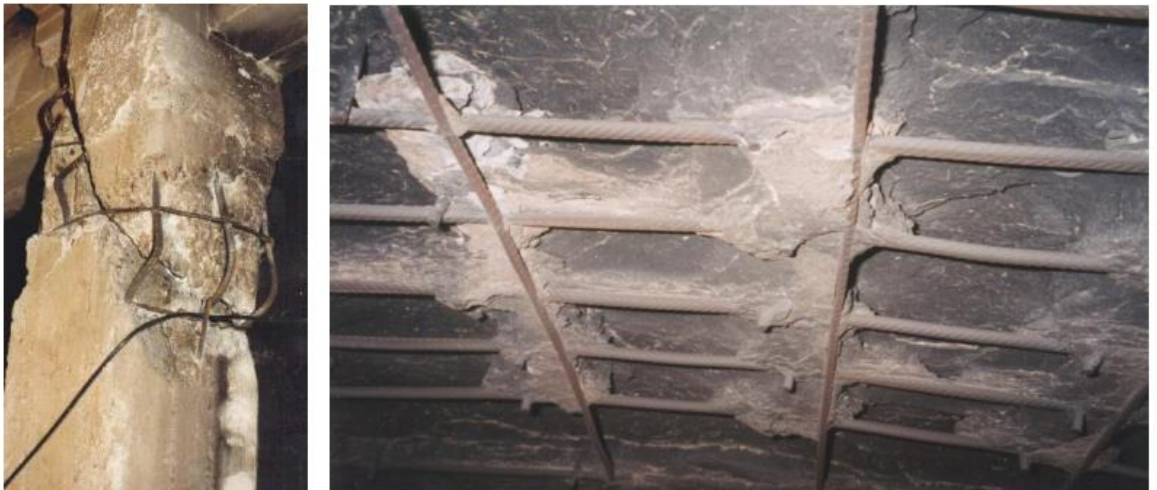
Figura 8.4.2 Fenomeno dello Spalling
