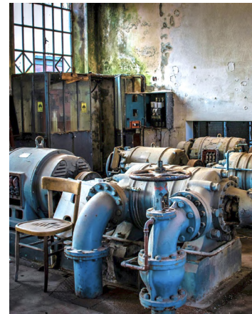
Fig.11 Interno della centrale dell'Acquedotto Renano, Immagine digitale: fondoambiente.it
