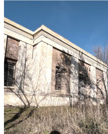
Fig.9 Esterno della centrale dell'Acquedotto Renano (Fda)
