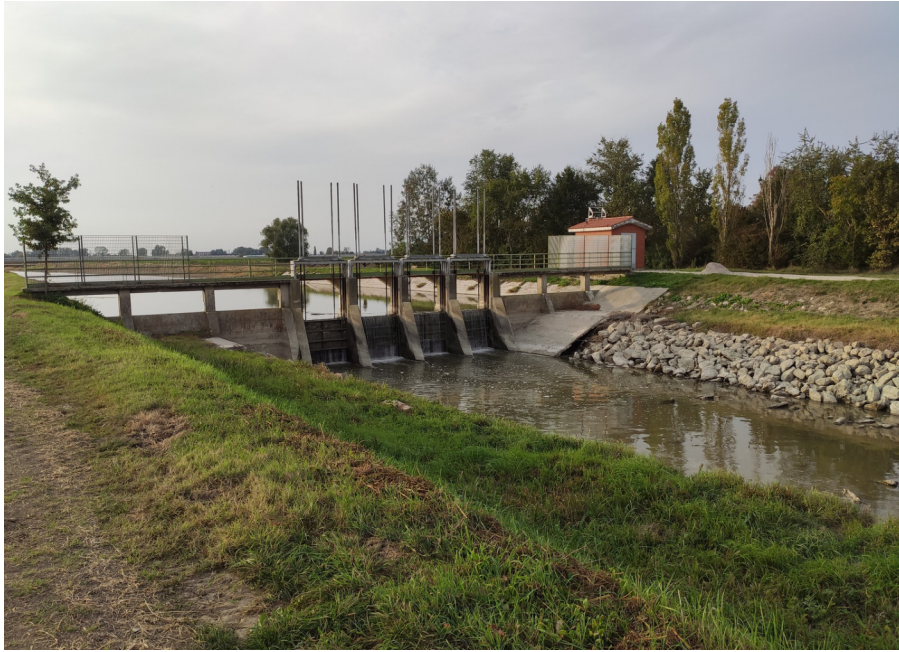
Figura 2.27: Vista del sostegno Sbocco del Quarantoli da valle, fotografia del 20/10/2022. Il bacino è in assetto irriguo: si possono notare le paratoie chiuse e l'invaso a monte.
