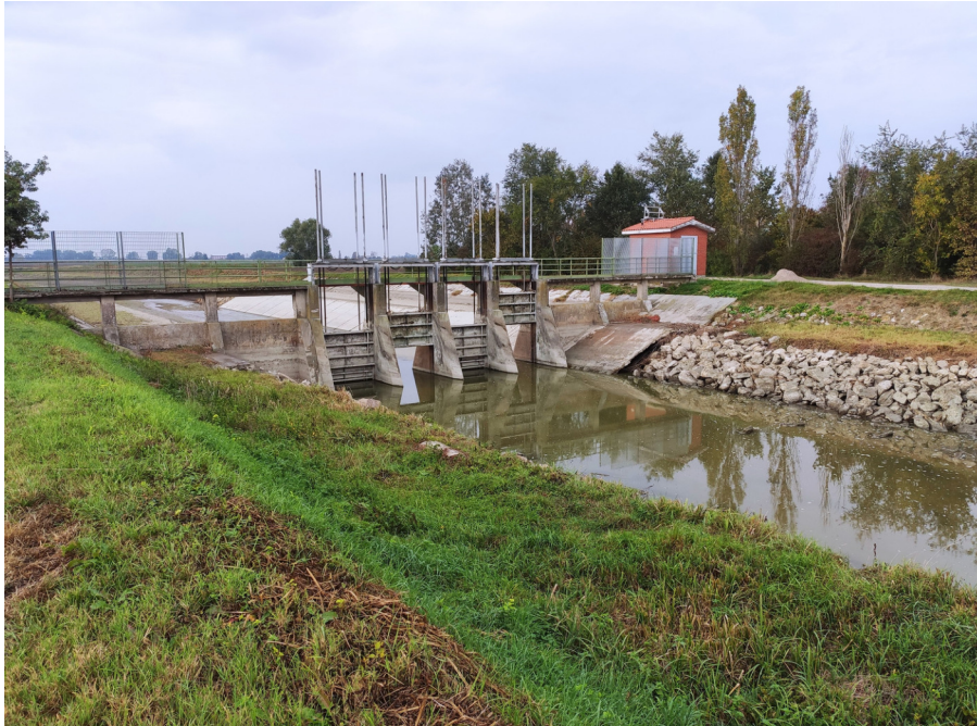
Figura 2.28: Vista del sostegno Sbrocco del Quarantoli da valle, fotografia del 2/11/2022. Il bacino è in assetto di scolo, le paratoie sono aperte e in alveo rimane solamente il deflusso di base.
