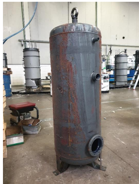
Figura 17 - Serbatoio HP1 vetroporcellanato
