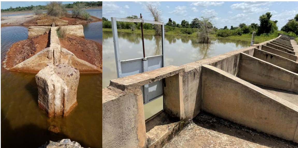
Figura 37.(A) Barrage diroccato per mancanza di manutenzione (B) Barrage con paratoie bloccate a causa del meccanismo arrugginito
