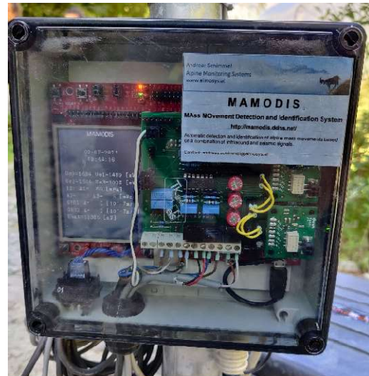
Figura 75. Sistema di registrazione segnali a infrasuoni MAMODIS installato nella stazione.
