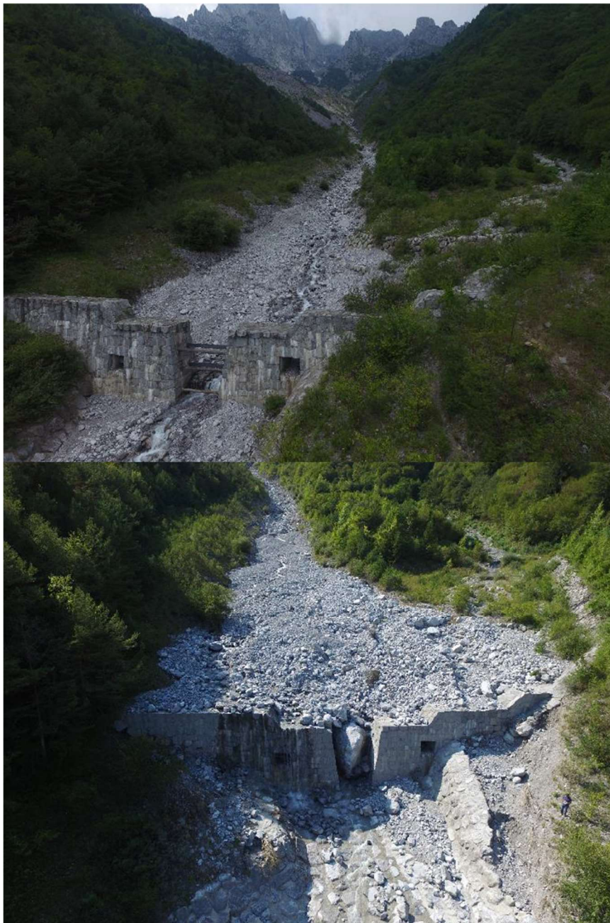
Figura 63. In alto una fotografia scattata della briglia "A" prima dell'evento del 2019. In basso la stessa a posteriore del debris-flow ( Albertelli., 2021 ).
