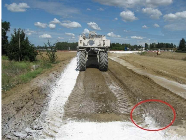
Fig. 5.30 – Identificazione dell'area della prima fascia con comportamento anomalo.
