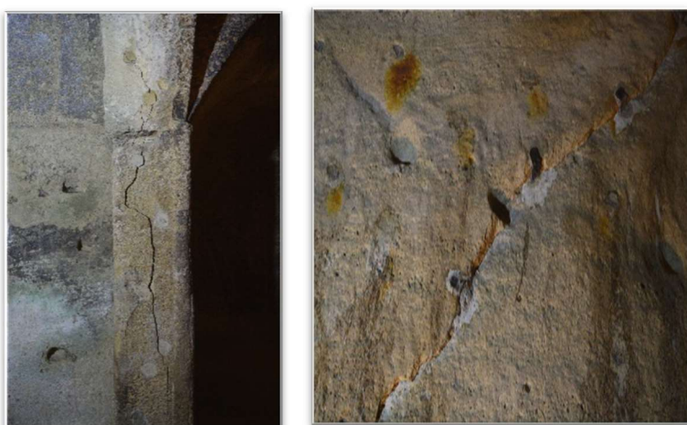
Figura 5.3: Fratture create dall'espansione delle barre passive
