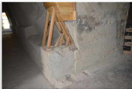
Figura 5.2: Stato attuale dello spigolo dell'Antro della Sibilla soggetto ad instabilità localizzate
