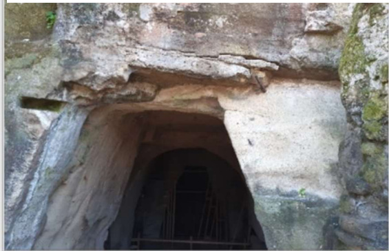
Figura 2.9: Degrado delle pareti causato da fenomeni di fotosintesi
