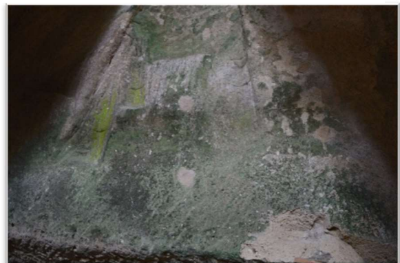
Figura 2.6; Degrado delle pareti causato da fenomeni di fotosintesi
