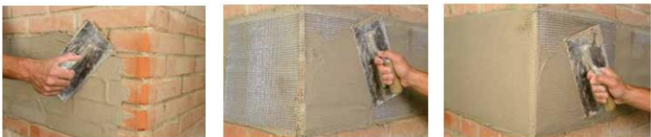
Figura 4.6: Applicazione prima mano di malta; installazione delle fasce di tessuto in fibra d'acciaio; applicazione seconda mano di malta [22]
