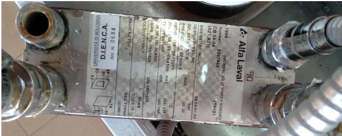
Figura 32. Scambiatore di calore posto all'interno del bagno termostatico freddo.
