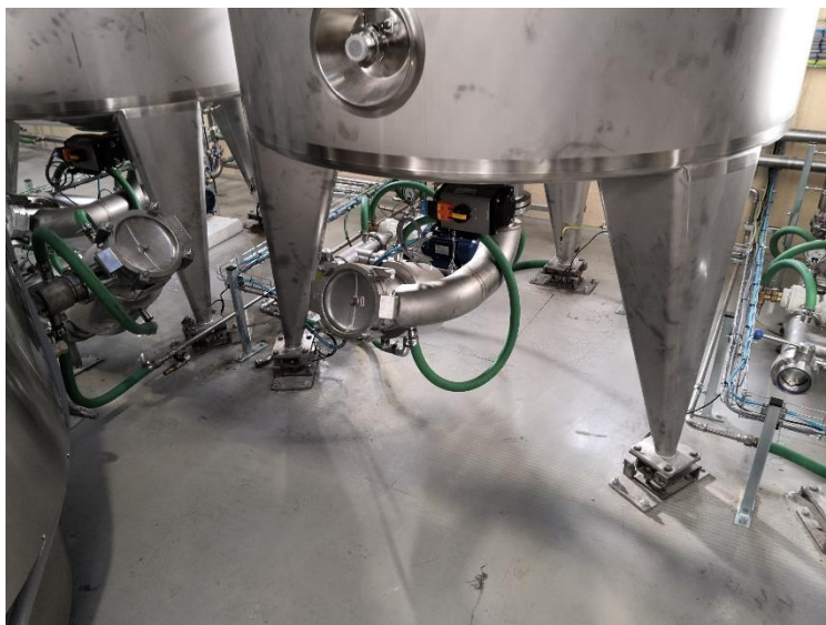
Fig.40 Particolare filtro sotto serbatoio da 3.75 mc
