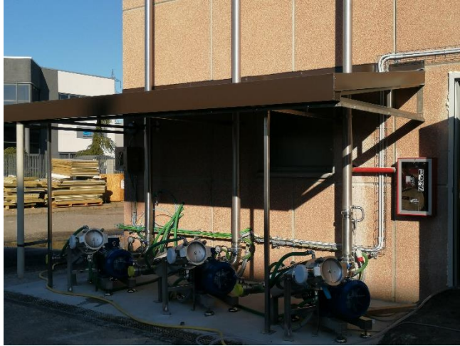
Fig.35 Particolare pompe di carico liquidi
