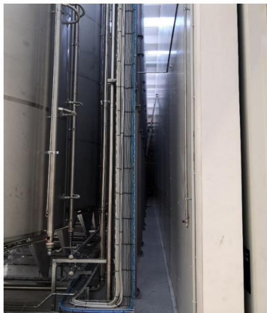
Fig.44 Particolare corridoio lasciato tra parete e piantoni di sostegno tubi
