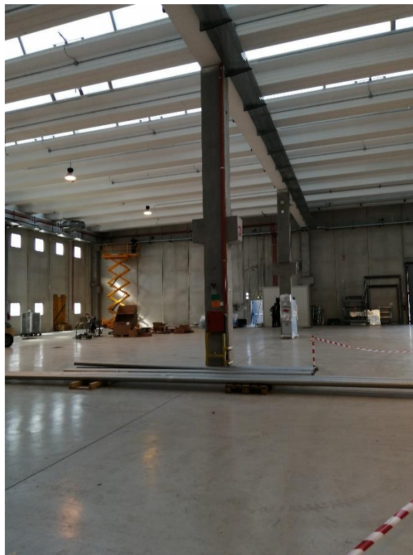
Fig.15 Particolare trave. Si noti come la zona sia stata sgomberata dalle strutture preesistenti
