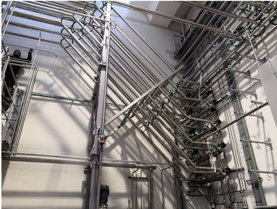
Fig.49 Particolare struttura a sostegno delle tubazioni che riforniscono la macchina per la produzione di creme bianche
