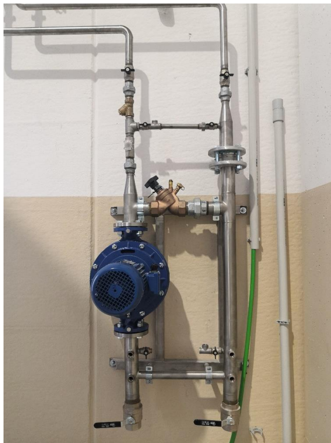
Fig.27 Centraline per l'acqua calda
