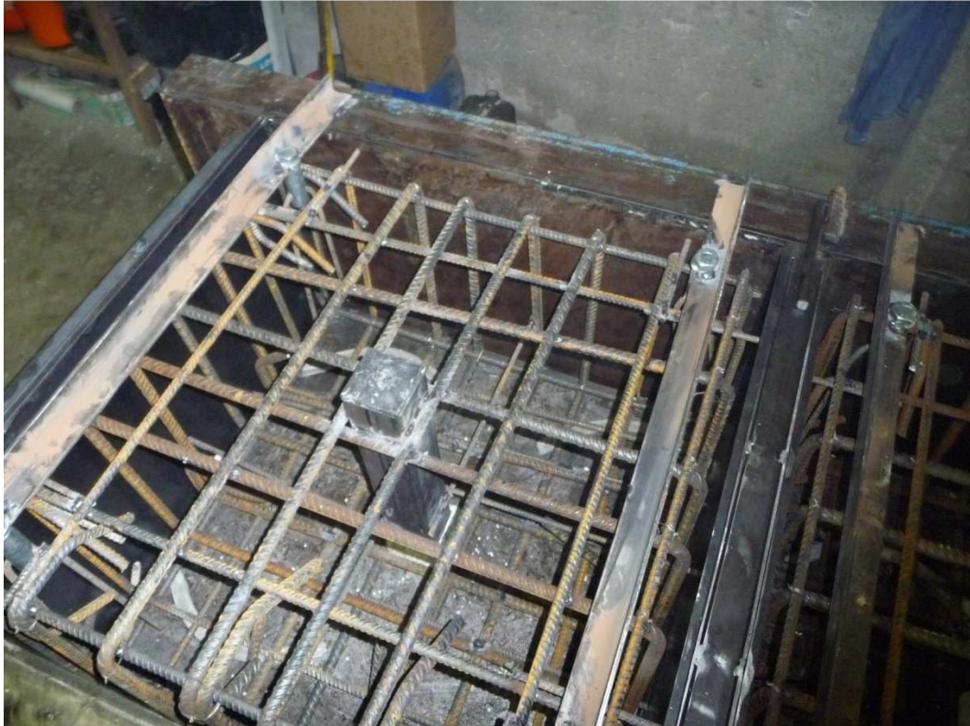
Figura 6.1 Particolare delle saldature tra le barre di armatura del plinto e lo scatolare che consentono a quest'ultimo di rimanere fermo durante il getto di calcestruzzo.
