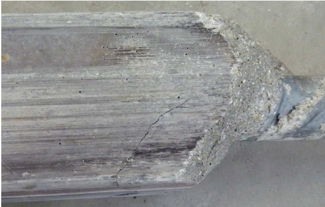
Figura 5.185 Particolare delle fessure presenti nell'EMACO estratto dal campione 2E1.
