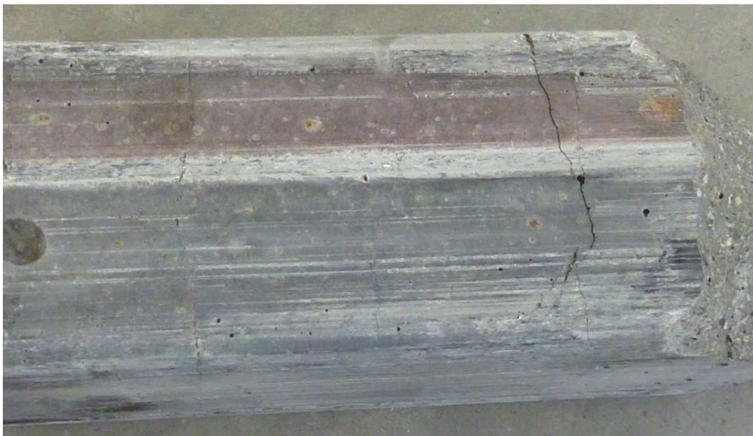
Figura 5.186 Particolare delle fessure presenti nell'EMACO estratto dal campione 2E1.
