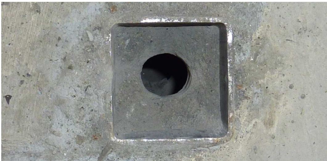
Figura 6.3 Particolare dell'interno dello scatolare una volta avvenuta l'estrazione totale della barra e del getto di EMACO.
