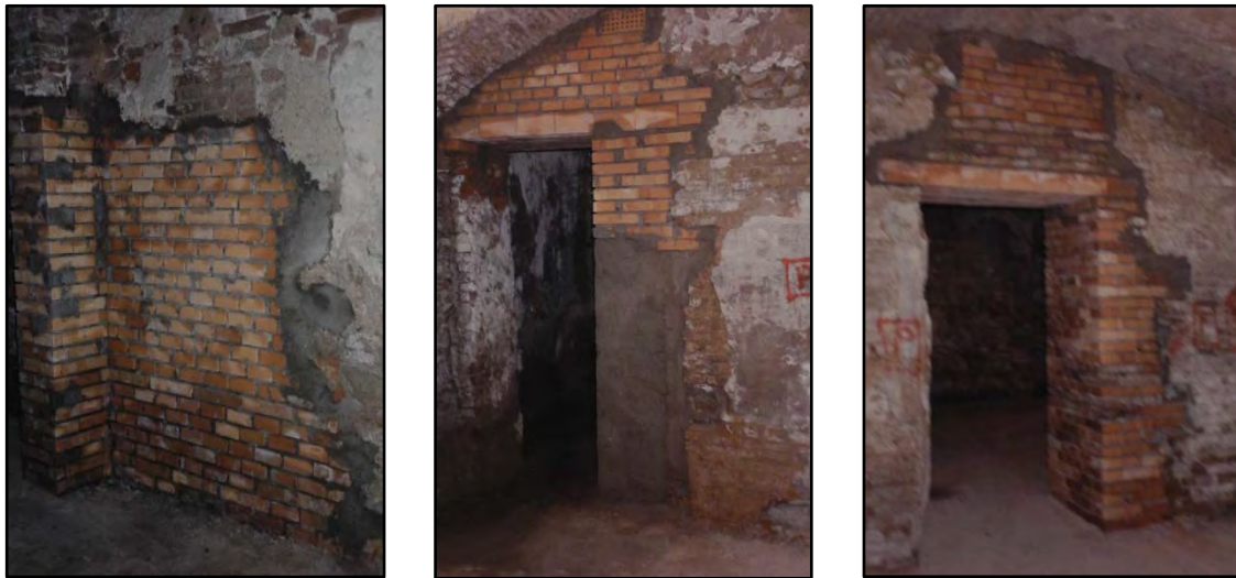
Figura 48-49-50: Foto dei lavori degli interventi di "cuci e scuci" nei paramenti murari lesionati e sostituzione dell'architrave sopra le aperture ove necessario
